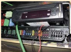
Lavori in corso: il lettore viene posizionato nel vano portaelettroniche dietro il cassetto portaoggetti.
